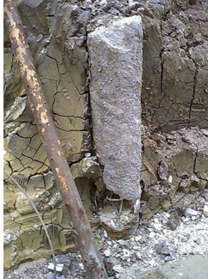
Figura 1 Pilote defectuoso fundido in-situ
