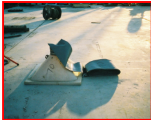
(d) Hopper and elephant trunk used to pour concrete into the FRP composite piles
